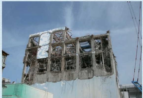
福島第一原子力発電所4号機(平成24年6月14日 福島県災害対策本部撮影)
